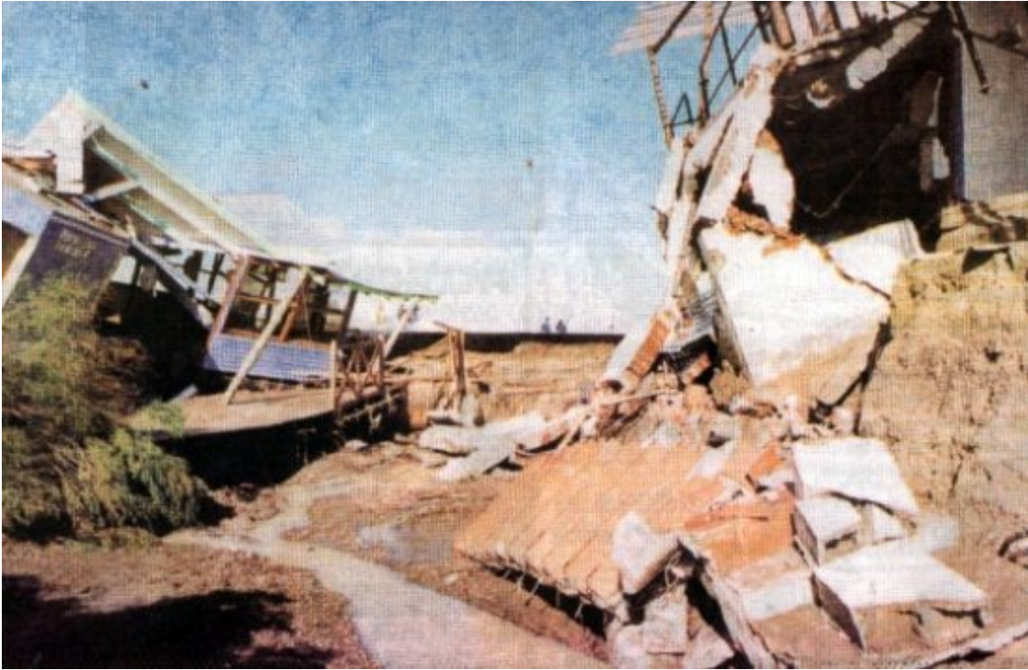
Desmoronamiento de las principales estructuras de los Complejos: Cucamonga y Rancho Aparte.
