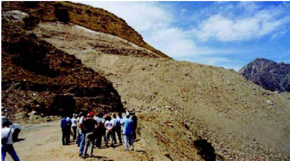
Figura 20. Ejemplos de movimiento en masa desencadenados por la construcción de una ruta.
