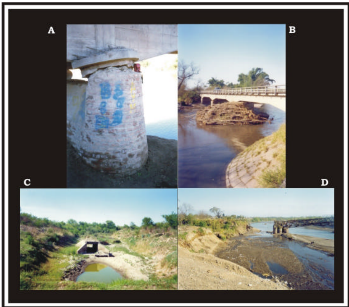
Figura 9: A. Ruptura del pilote central en el puente sobre el río Marapa en la ruta 38. B. Luz del puente sobre el río Chico parcialmente tapada por desechos varios en la ruta 157. C. Pequeña obra de desagüe sobre un arroyo que ha quedado superado por los nuevos caudales del mismo. D. Restos del viejo puente de ferrocarril ubicado sobre las aguas del río Medina en la localidad de Aguilares.
