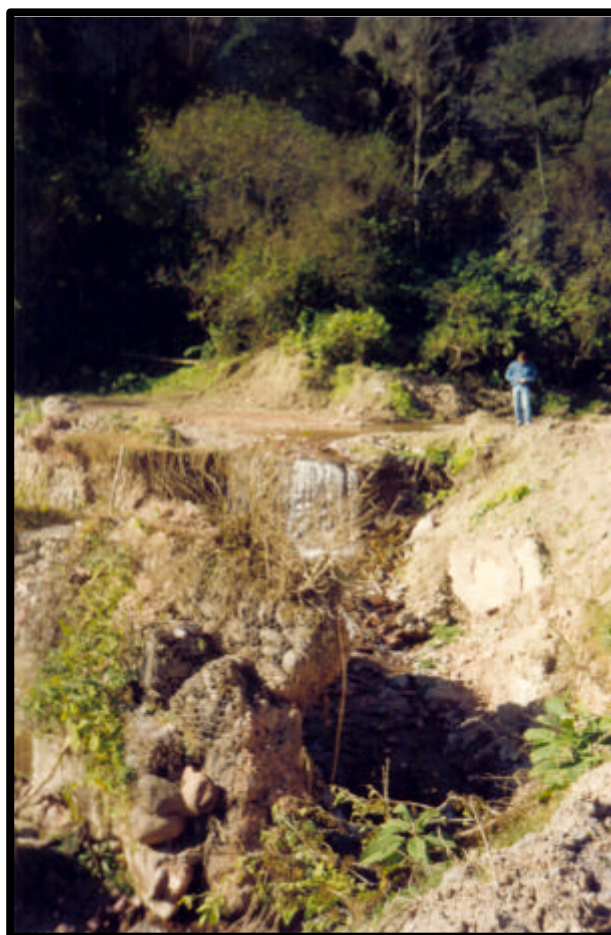
Foto 21: Proceso de erosión fluvial sobre la ruta 308, camino a la localidad de Escaba
