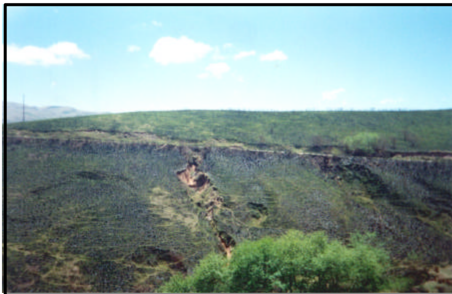
Foto 13: Procesos de cárcavamiento, formación de terracetas y deslizamientos varios sobre una ladera sometida al sobrepastoreo y a la quema anual sobre la ruta 1 entre las localidades de Singuil y Las Chacritas, provincia de Catamarca.
