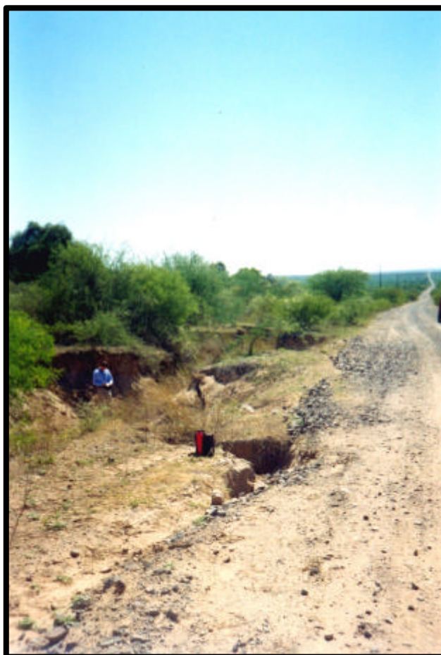
Foto 17: Proceso de cárcavamiento al costado de la ruta 10, entre las localidades de San Pedro de Guasayán y Villa de Guasayán.
