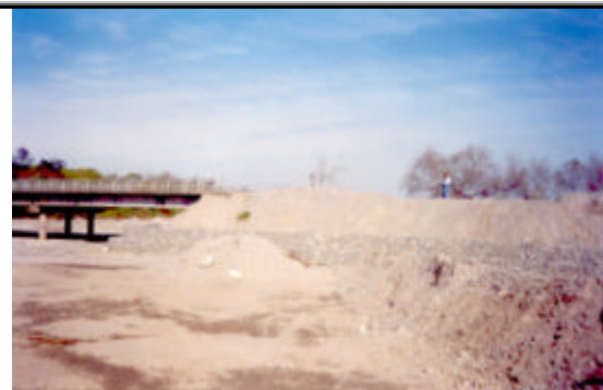
Foto 10: Refacción del estribo sur y protección del mismo mediante gaviones en el río Los Sosa, en la ruta 324.
