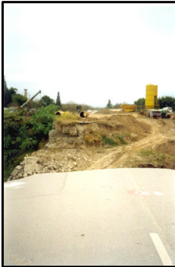
Foto 20: Puente destruido por erosión fluvial en el arroyo El Sueño
