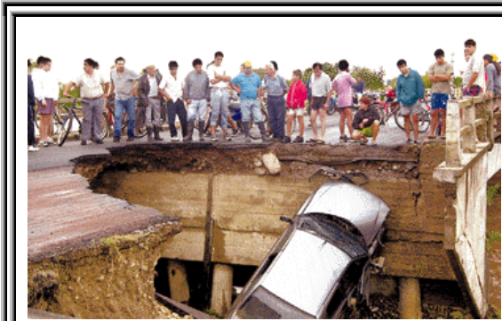
Foto 7: Erosión del estribo norte del puente sobre el río Romano, en la ruta 38 (foto tomada del diario La Gaceta).
