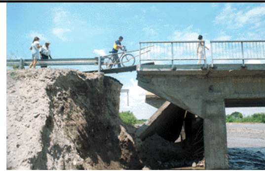
Foto 8: Erosión lateral con rotura de estribo en el puente sobre el río Caspinchango, en la ruta 324 (foto tomada del diario La Gaceta).
